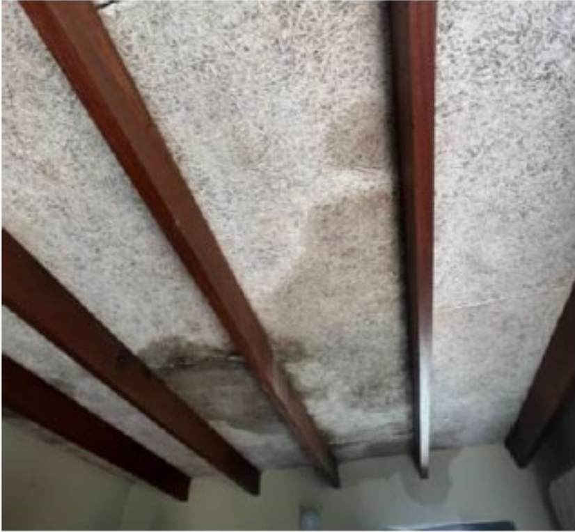
Imagen 3.1 Techo afectado por filtración
