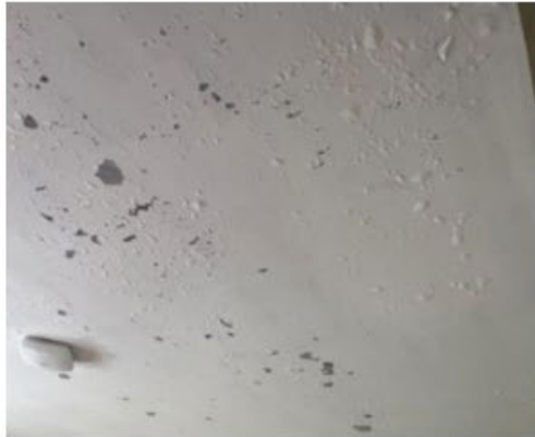
Imagen 1.1(Techo con filtraciones)
