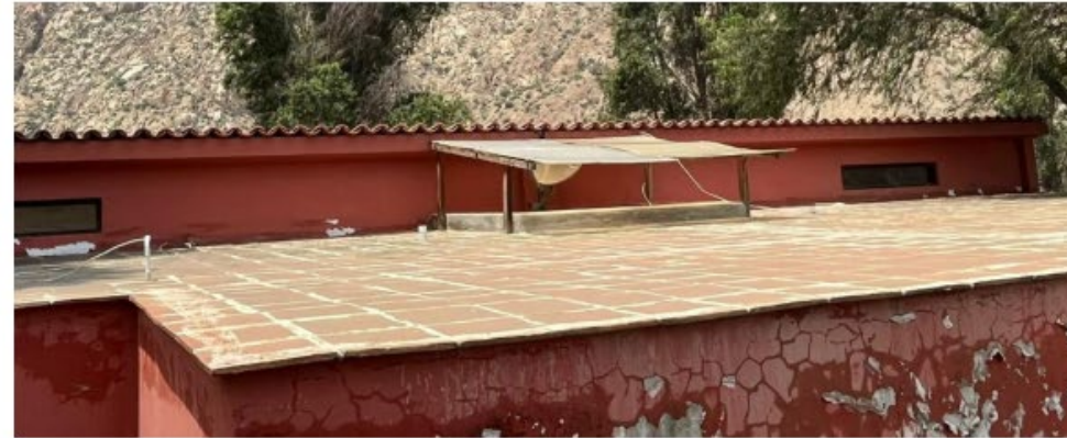
Imagen 1.1(vista exterior de techo con filtración)
