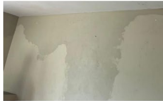
Imagen 1.5 (Paredes con filtraciones)
